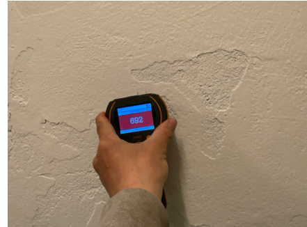
Fukt på hvert trappetrinn.
