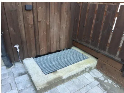
Grunnmuren er ikke tilgjengelig for undersøkelser.
