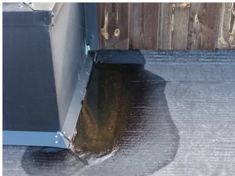
Det registreres vannsamling ved luftebeslag.
