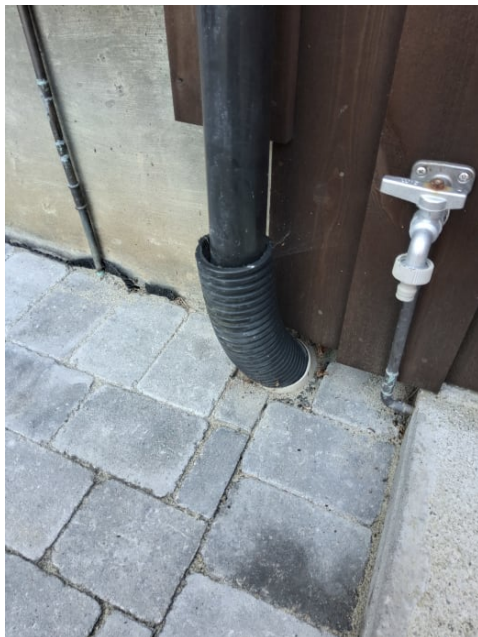
Taknedløp er ledet til lukket rør.
