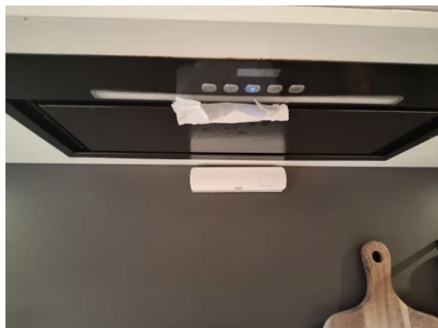
Avtrekkseffekten er testet med papir.
