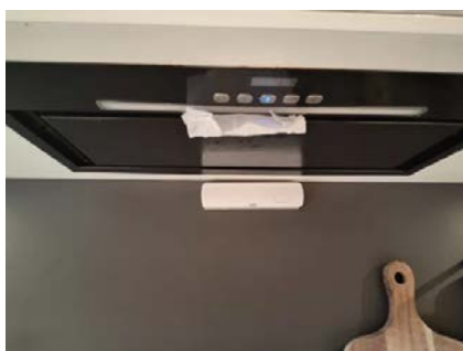
Avtrekkseffekten er testet med papir.
