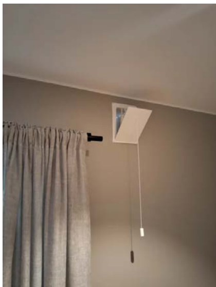
Klaffventil på yttervegg.
