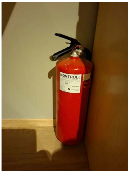
Brannslukningsapparat er plassert under trapp.
