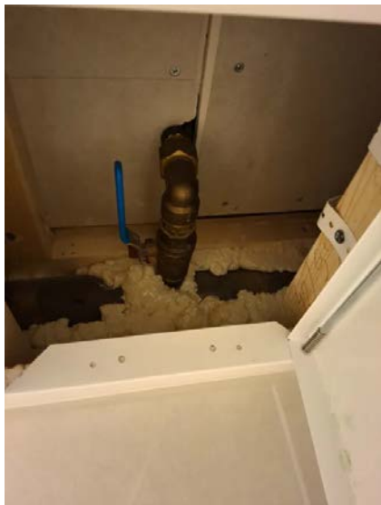
Hovedstoppekran er plassert i himling over badekar.
