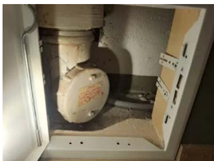
Stakeluke og avløpsrør fra byggeår.
