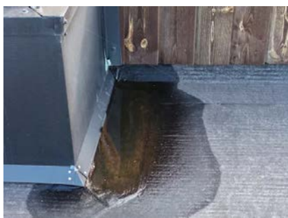
Det registreres vannsamling ved luftebeslag.
