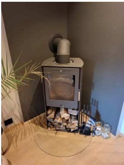
Vedovn med glassdør i stue.
