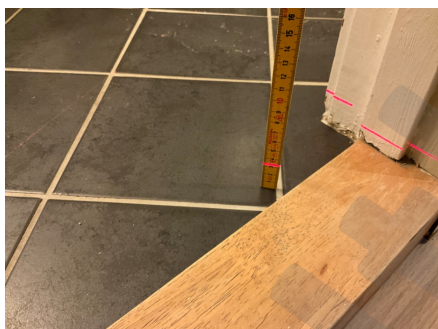
Fuktskader på karmen.
