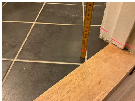
Fuktskader på karmen.
