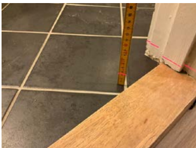
Fuktskader på karmen.
