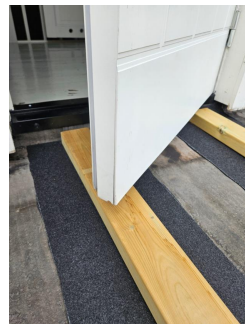
Påbegynnende skade i bunn på dør til takterrasse.
