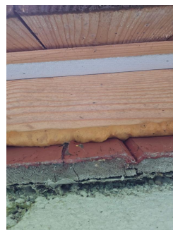
Begrenset ventilasjon bak utvendig kledning.
