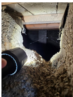
Krypkjeller under hoveddel lot seg ikke kontrollere.
