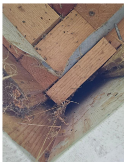
Musesikring mangler i hjørnekasser.
