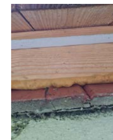
Begrenset ventilasjon bak utvendig kledning.
