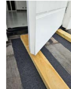
Påbegynnende skade i bunn på dør til takterrasse.
