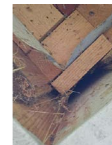
Musesikring mangler i hjørnekasser.
