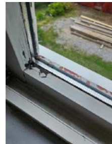
Eksempel på vindu med høy slitasje.
