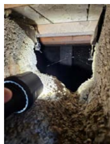
Krypkjeller under hoveddel lot seg ikke kontrollere.
