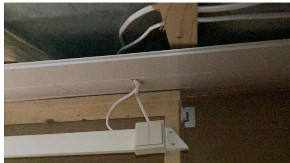
Noe ufagmessig utførelse på ledninger på kneloft, det er ikke brukt trekkerør med tanke på gjennomføringer i treverk.
