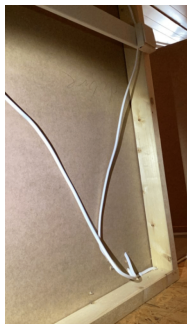
Ledninger på kneloft ikke tilstrekkelig festet.
