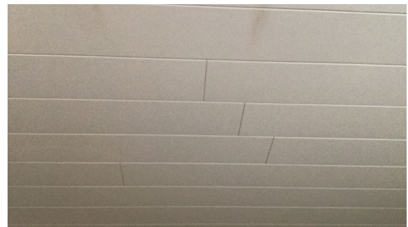
Ufagmessig utførelse på deler av arbeid.
