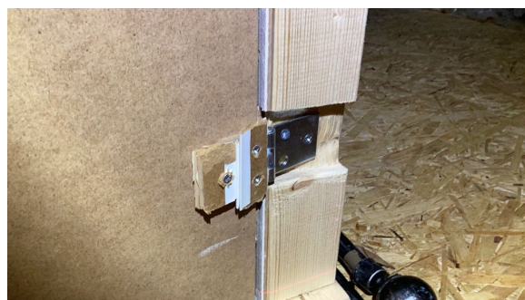
Ufagmessig utførelse på hengslen av loftsluke.
