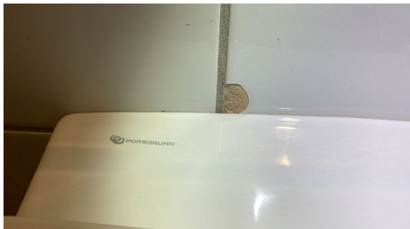
Avskalling på flis registrert på dokasse.
