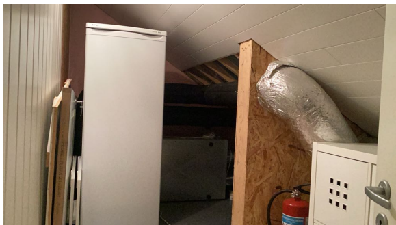
Gjenstående arbeid på bod/teknisk rom.
