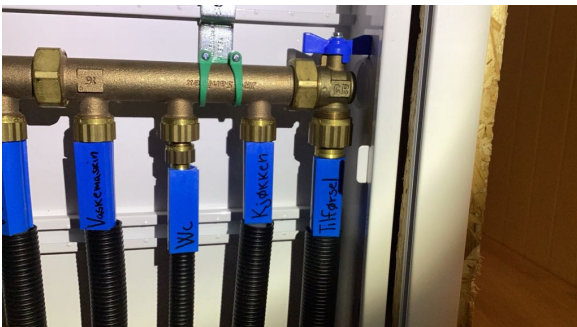
Stoppekran i fordelersskap.
