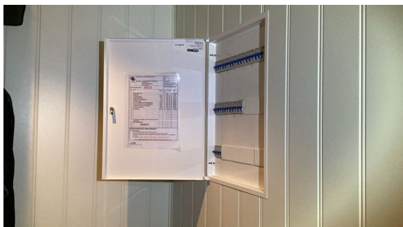
Sikringsskap på garderobe.
