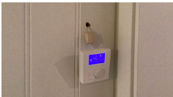
Ufagmessig utførelse på innfesting av bryterpanel.
