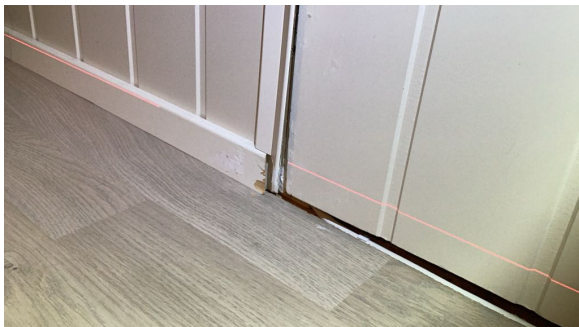
Ufagmessig utførelse på deler av arbeid.
