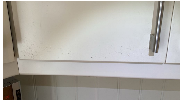
Malingflass og riper på enkelte skapdører.
