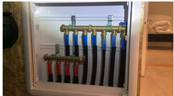
Fordelersskap på bod/teknisk rom.
