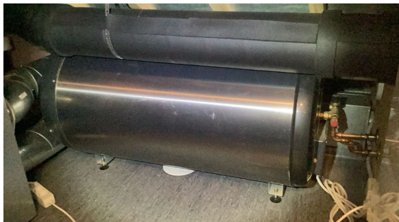
Varmtvannsbereder lokalisert på bod/teknisk rom.
