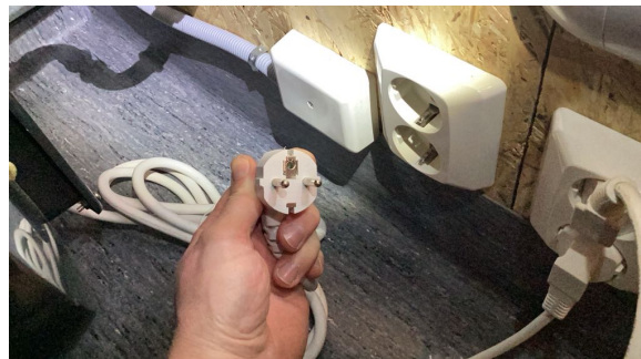
Sjekk av støpsel.
