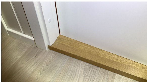
Dørblad til bod/teknisk rom tar i terskel.
