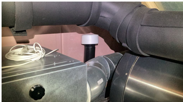
Litt kloakklukt på bod/teknisk rom.
