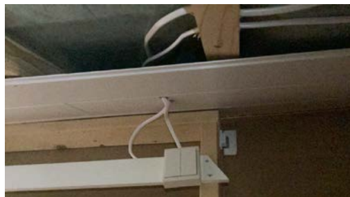
Noe ufagmessig utførelse på ledninger på kneloft, det er ikke brukt trekkerør med tanke på gjennomføringer i treverk.
