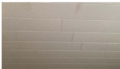
Ufagmessig utførelse på deler av arbeid.
