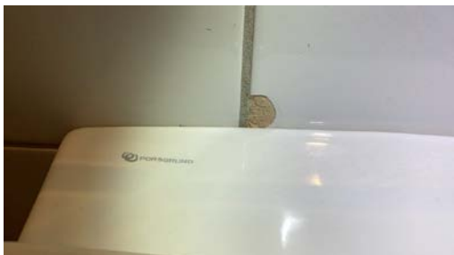
Avskalling på flis registrert på dokasse.
