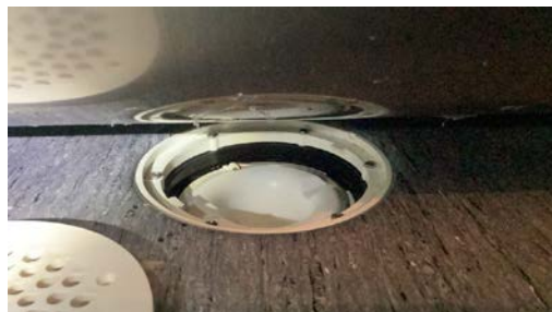
Belegg på bod/teknisk rom er ikke ført tilstrekkelig under klemring i sluk.
