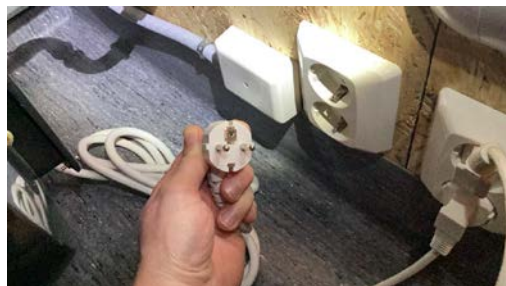
Sjekk av støpsel.
