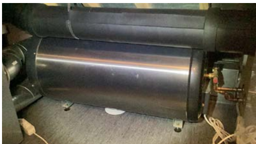
Varmtvannsbereider lokalisert på bod/teknisk rom.
