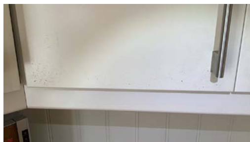
Malingflass og riper på enkelte skapdører.
