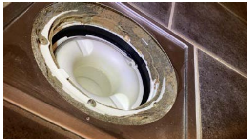
Deler av klemring er tildekket, dette er ikke en anbefalt løsning.
