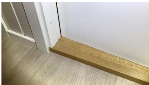
Dørblad til bod/teknisk rom tar i terskel.
