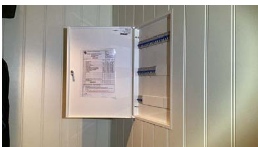
Sikringsskap på garderobe.
