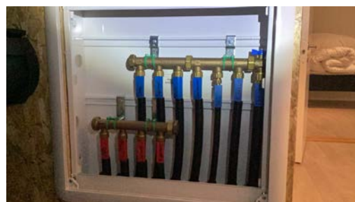
Fordelersskap på bod/teknisk rom.
