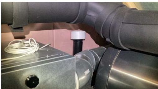
Litt kloakklukt på bod/teknisk rom.
