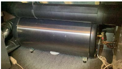
Varmtvannsbereider lokalisert på bod/teknisk rom.
