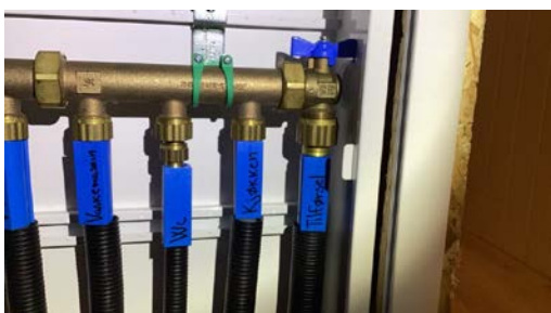
Stoppekran i fordelersskap.
