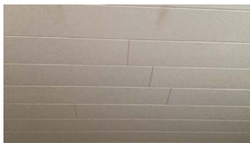
Ufagmessig utførelse på deler av arbeid.
