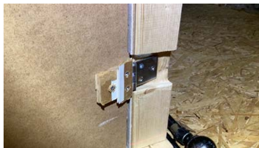
Ufagmessig utførelse på hengslen av loftsluke.
