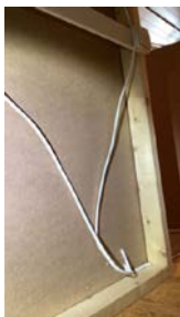
Ledninger på kneloft ikke tilstrekkelig festet.
