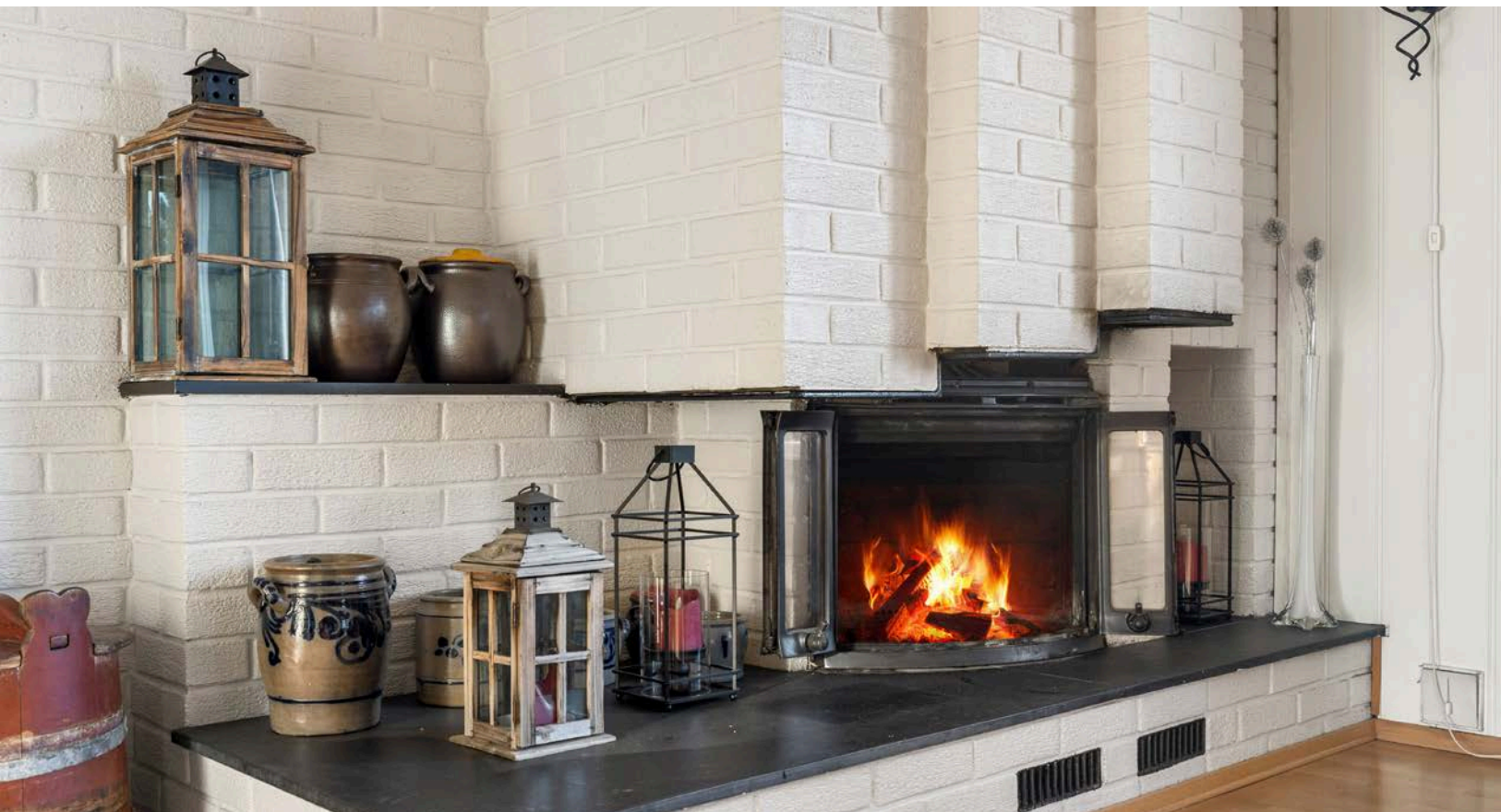
I stuen er det en koselig peis, men pipeløpet må rehabiliteres før den kan brukes, pga. krakelering i røykrør.
