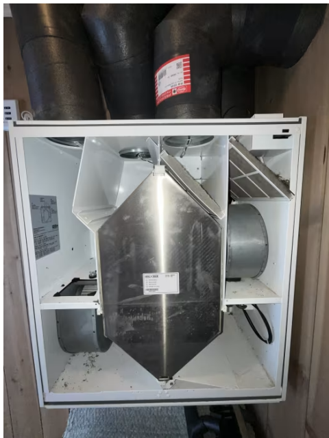
Viser ventilasjonsanlegg innvendig.
