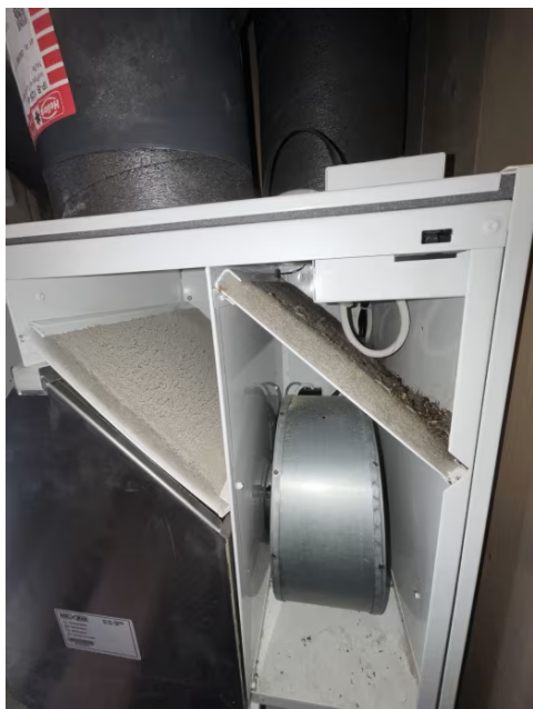
Filter er tilsmusset og bør skiftes.
