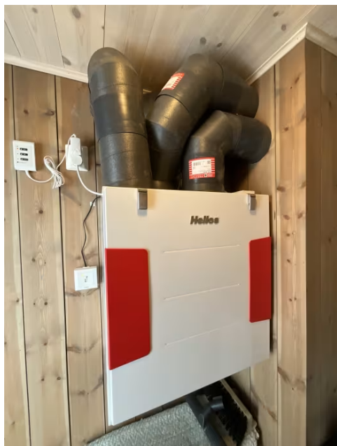
Viser ventilasjonsaggregat plassert i bod.
