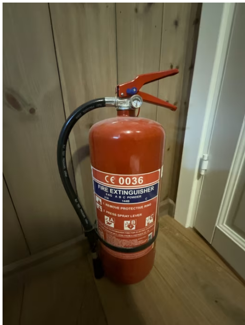
Viser brannslukningsapparat plassert bak dør på soverom.
