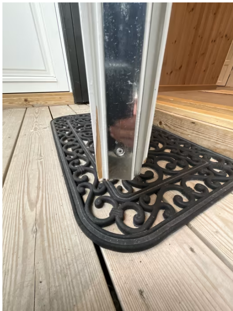
Viser mindre skade ved ytterdør.
