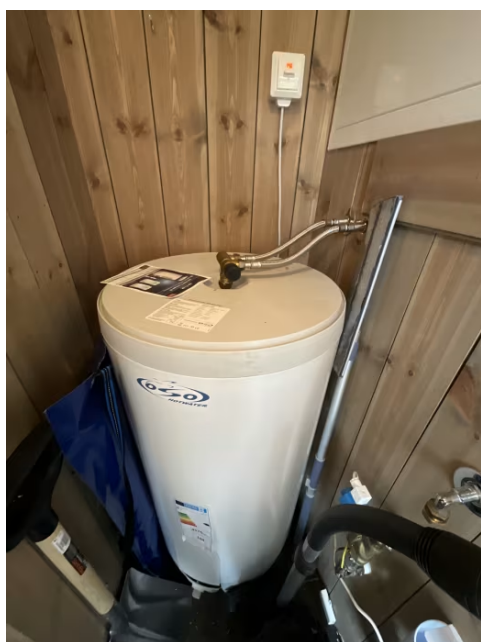
Viser varmtvannsbereder plassert i bod.
