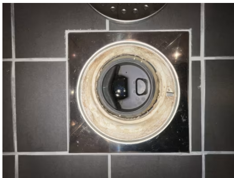
Viser sluk i dusjonen.
