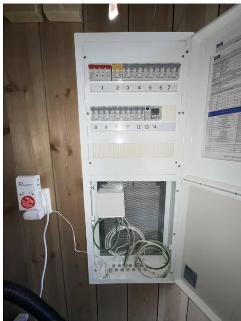
Viser sikringsskap plassert i bod med utvendig adkomst.
