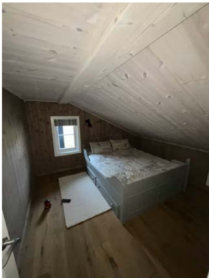
Viser innredet soverom uten godkjent rømningsvei.
