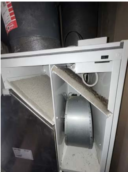
Filter er tilsmusset og bør skiftes.
