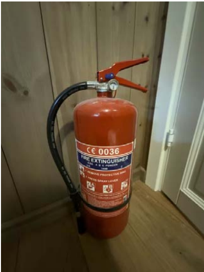
Viser brannslukningsapparat plassert bak dør på soverom.
