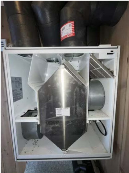
Viser ventilasjonsanlegg innvendig.
