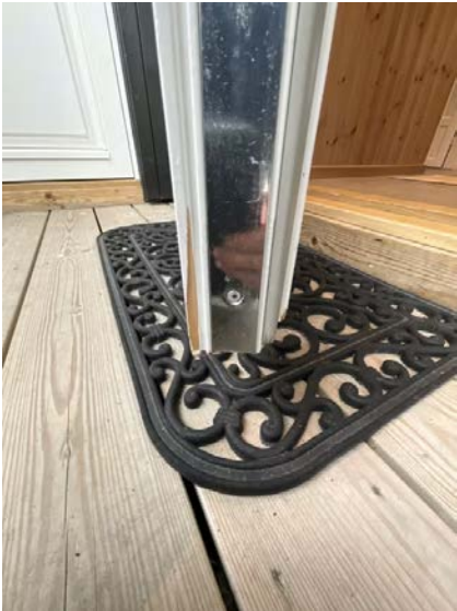
Viser mindre skade ved ytterdør.
