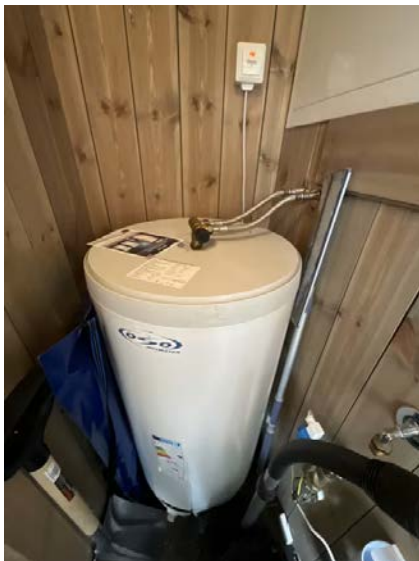
Viser varmtvannsbereder plassert i bod.
