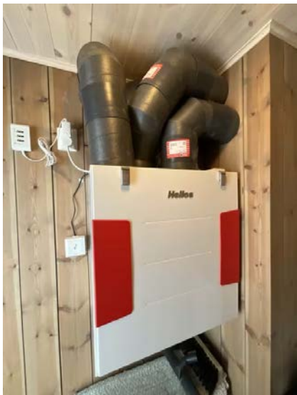
Viser ventilasjonsaggregat plassert i bod.
