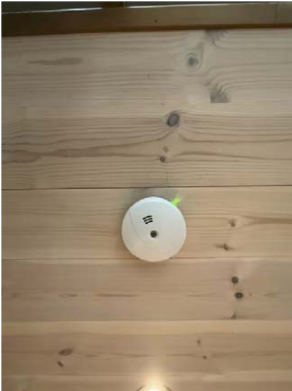
Viser brannvarsler i himling.
