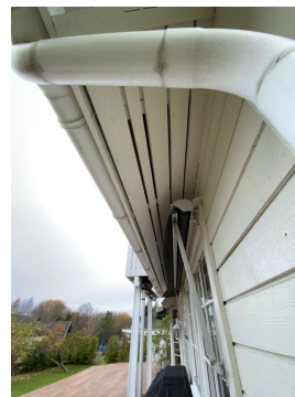
Synlige luftespalter i gesimskasse.
