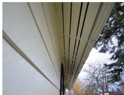
Synlige luftespalter i gesimskasse.
