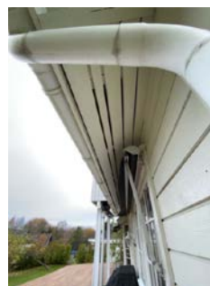
Synlige luftespalter i gesimskasse.
