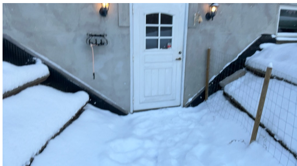
Dør mangler beslag under terskel.
