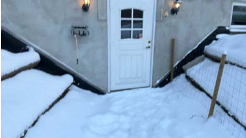
Dør mangler beslag under terskel.
