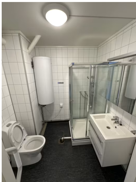
Viser installasjoner på bad
