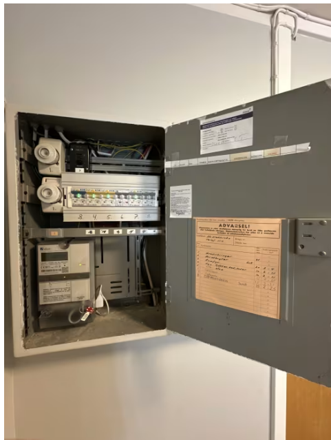
Viser sikringsskap og kursfortegnelse. Sikringsskap plassert i felles gang.
