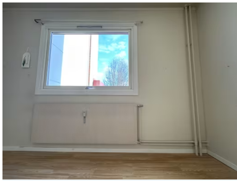
Viser radiator montert på soverom.
