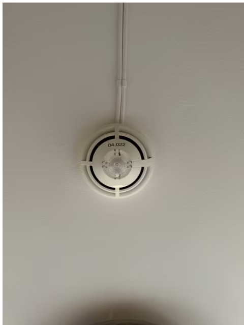
Viser brannvarsler tilknyttet brannsentral i trappeoppgangen.
