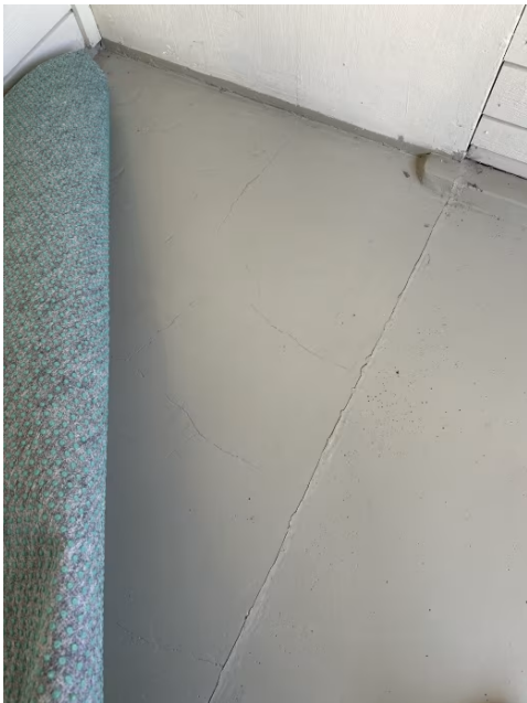
Det registreres sprekk i betonggulv.
