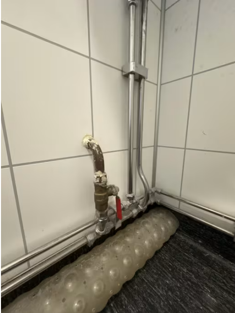
Viser vanninntak og hovedstoppekran plassert på badet.
