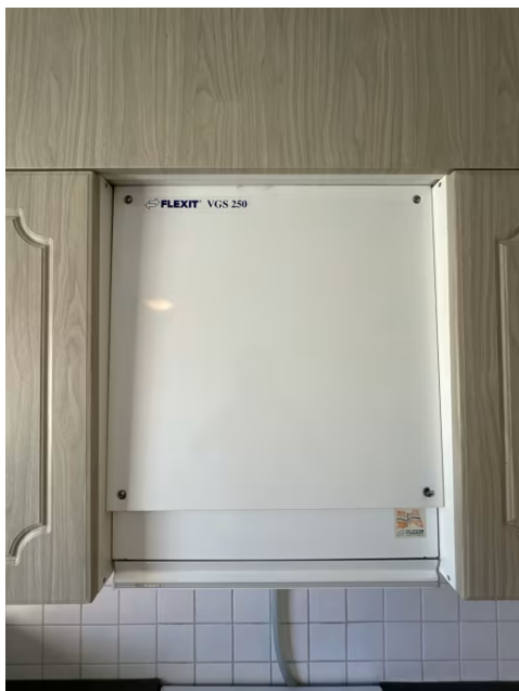
Viser ventilasjonsaggregat plassert på kjøkkenet.
