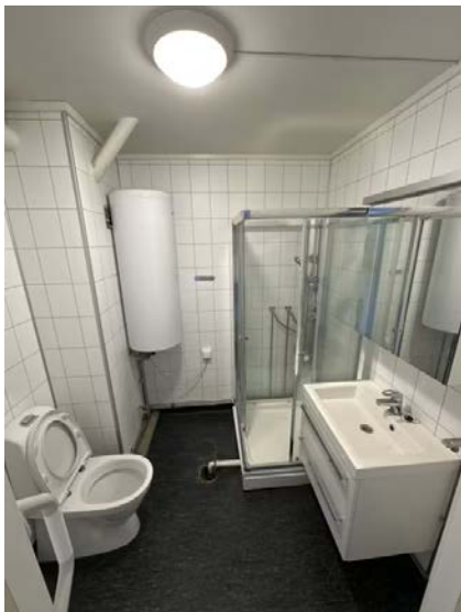
Viser installasjoner på bad
