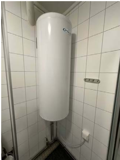
Viser vegghengt bereder plassert på badet.
