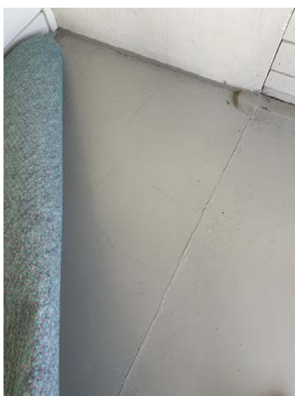
Det registreres sprekk i betonggulv.
