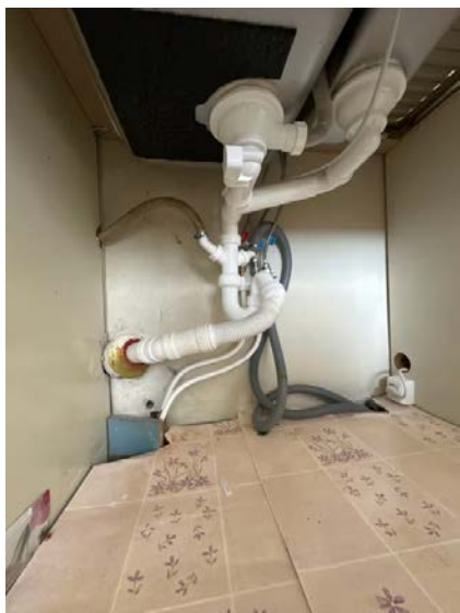
Viser vann og avløpsinstallasjoner under kum.
