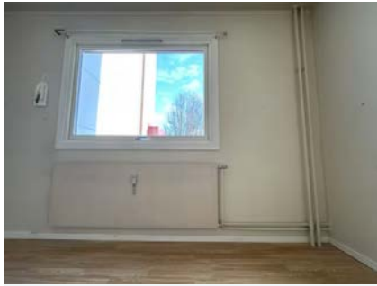
Viser radiator montert på soverom.
