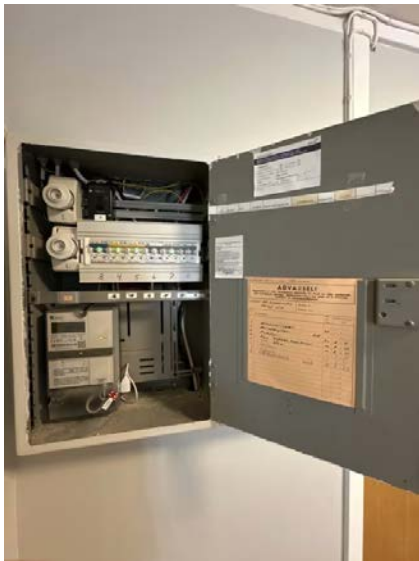
Viser sikringskap og kursfortegnelse. Sikringskap plassert i felles gang.
