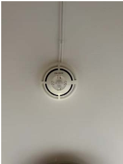
Viser brannvarsler tilknyttet brannsentral i trappeoppgangen.
