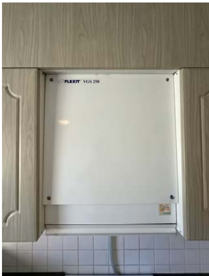
Viser ventilasjonsaggregat plassert på kjøkkenet.
