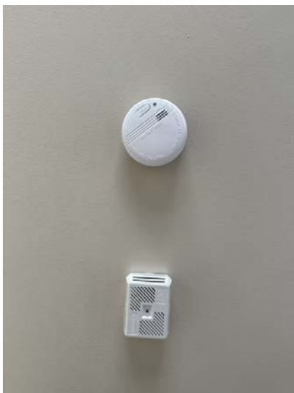
Viser brannvarsling på soverom.
