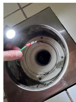
Løs jordningskabel. Må festes til slukrist.
