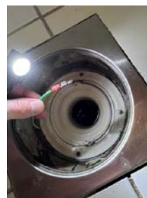
Løs jordningskabel. Må festes til slukrist.
