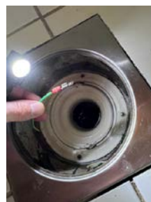
Løs jordningskabel. Må festes til slukrist.
