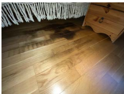
Synlige skader på gulv.
