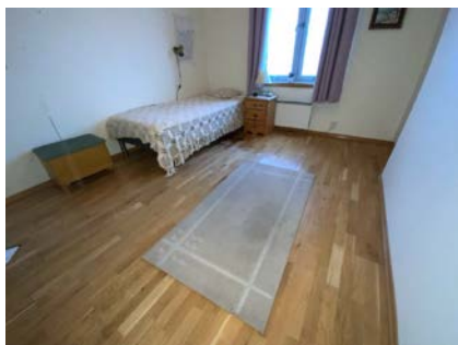
Synlige skader på gulv.
