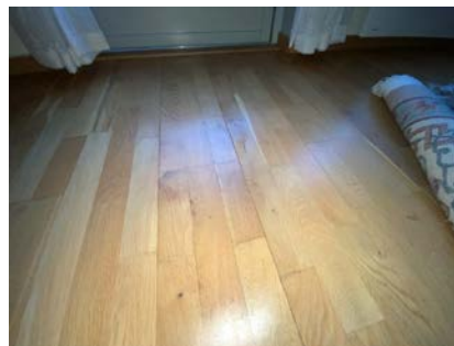
Synlige skader på gulv.
