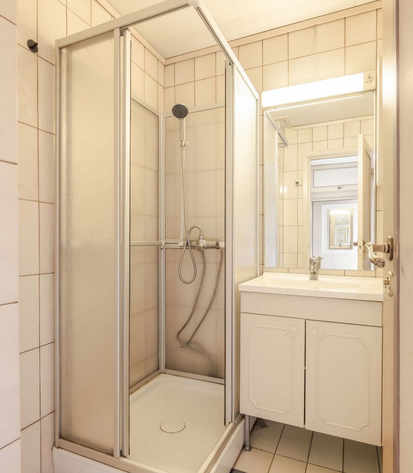
Flislagt bad med dusjkabinett og baderomsinnredning med underskap og heldekkende servant. Speil og lys med elektrisk uttak i overkant av servanten. Badet har behov for oppgradering for å tilfredsstille dagens krav til standard.
