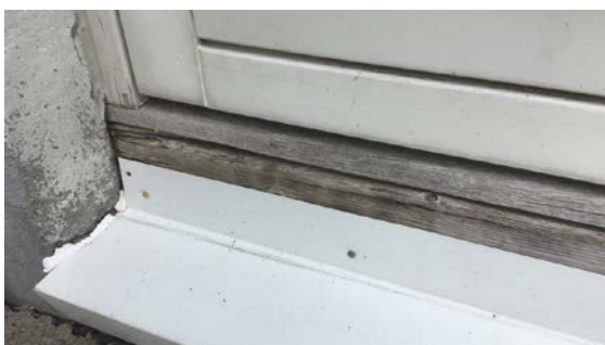
Mangler beslag under kjellerdør
