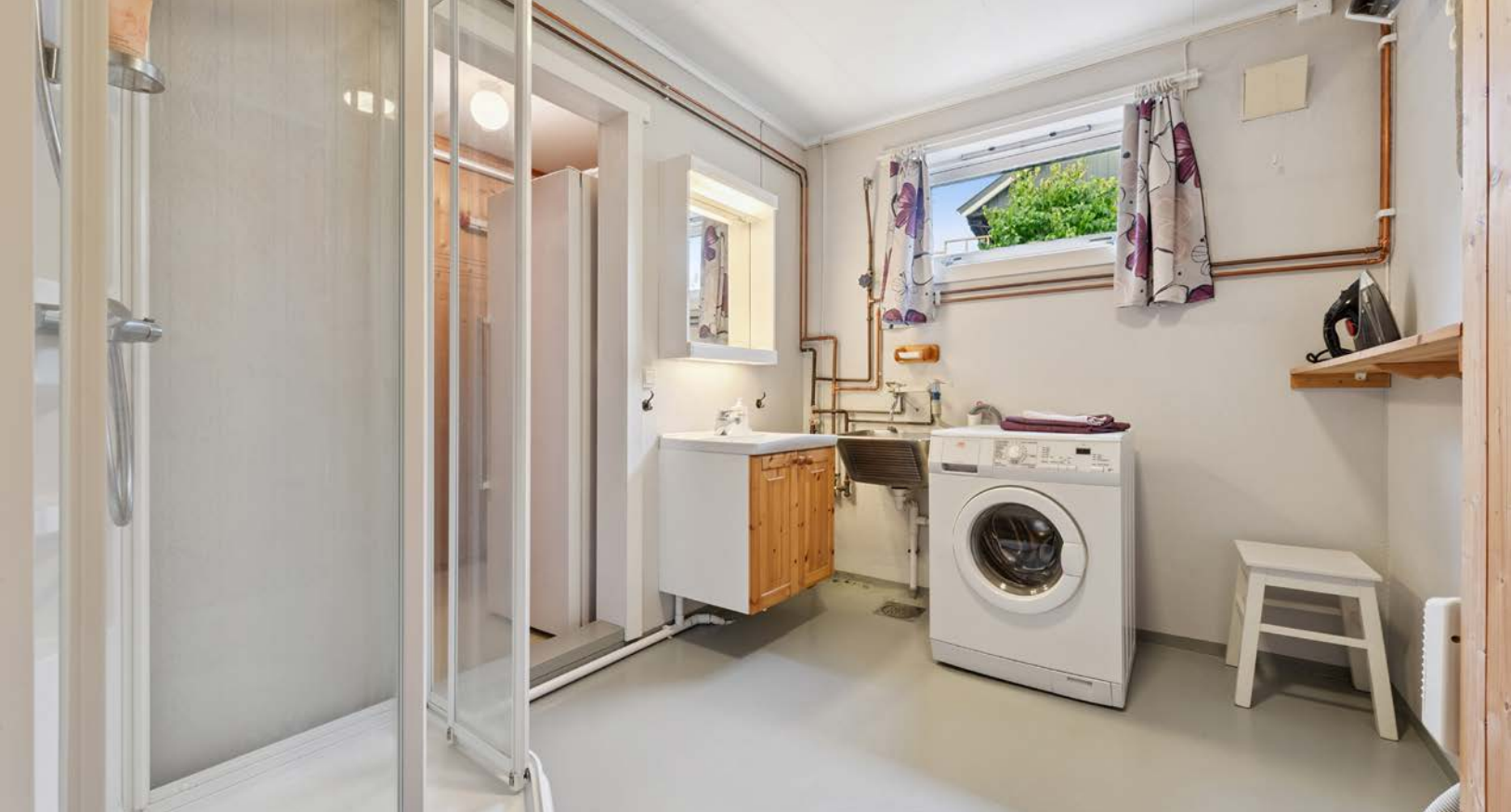
Vaskerom med servant i baderomsinnredning, dusjkabinett og utslagsvask. Her er det opplegg for vaskemaskin.
