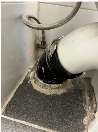
Unøyaktig utskjæring i flis - Mye "gris" med silikon og fugemasse
