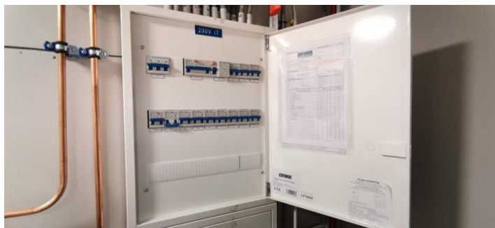
Kontroll av el-skapet.
