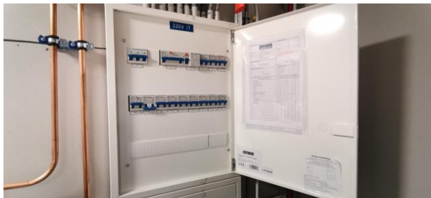
Kontroll av el-skapet.
