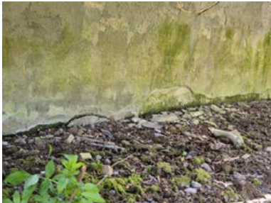
Løs puss under terrasse.
