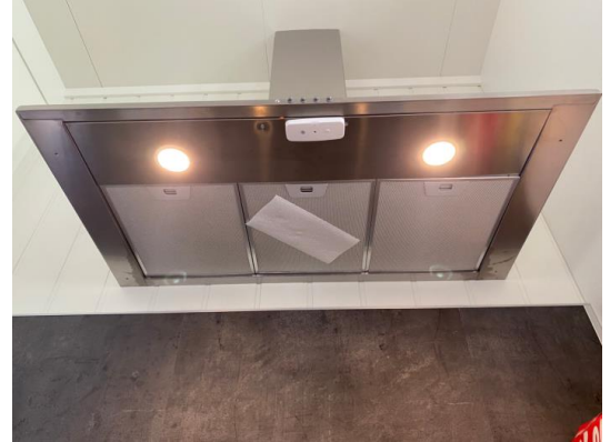
Funksjonstest av ventilator.
