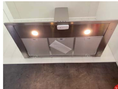
Funksjonstest av ventilator.
