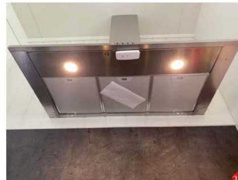
Funksjonstest av ventilator.
