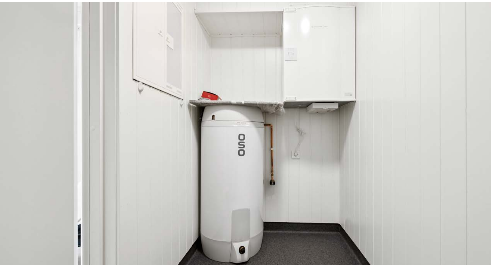
Teknisk rom med 200l VV-bereder.
