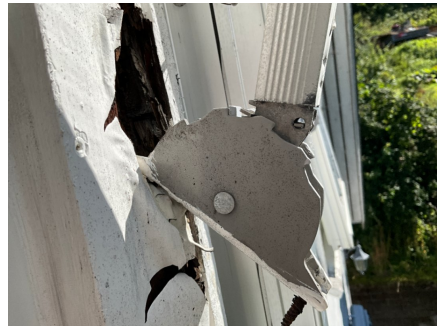
Liten råteflekk på veggen mot sør.
