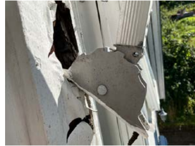
Liten råteflekk på veggen mot sør.
