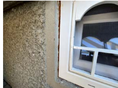
Ikke tett mellom puss og vindu, mangler beslag.
