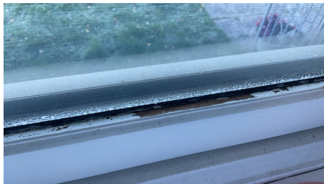
Forårsaker fuktpåkjenning og slitasje med avflassing i karm
