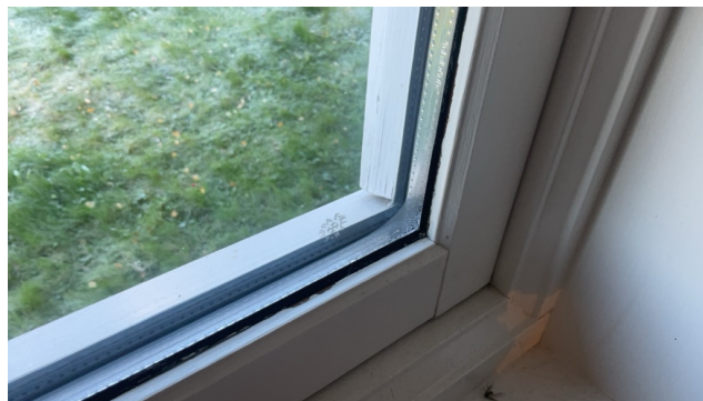
Kondensering er registrert på glass ubder befarig på flere vinduer
