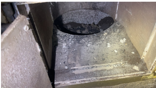
Manglende støpt bunn i sotluke i pipebunn
