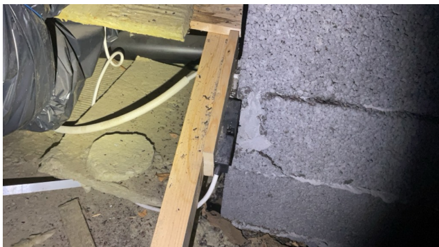
Det er foretatt avskaling av hjørne på pipe fra kryploft grunnnet koblingsboks for avtrekk, sprekkdannelse på pipe i dette området
