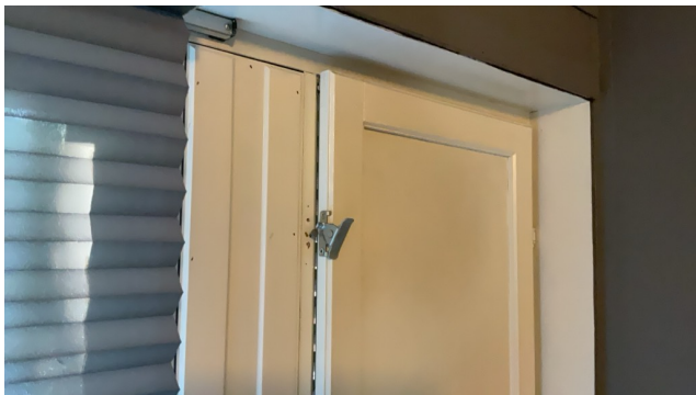
Ikke tilstrekkelig lukkemekanisme
