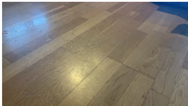
Slitasje på gulvoverflate
