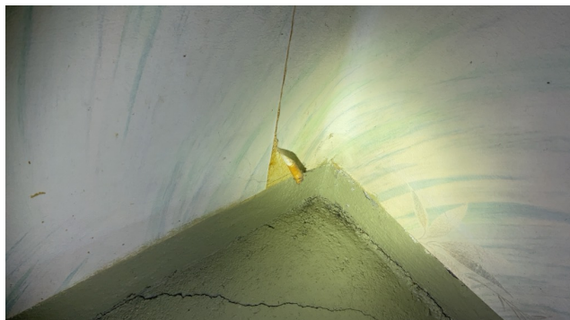
Slitasje på tapet
