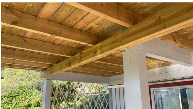
Bør vurderes understøtning av bærebjelke på terrasse jmf snøtyngde
