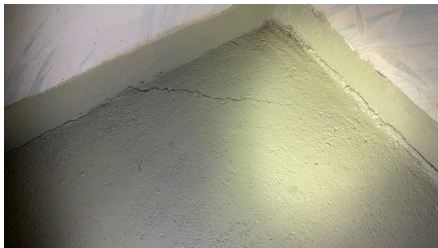
Sprekk i gulv
