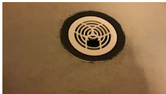
Ikke tilstrekkelig tettesjikt på gulv og overgang sluk
