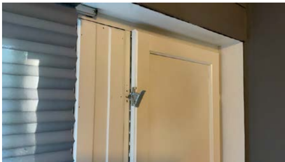
Ikke tilstrekkelig lukkemekanisme
