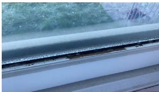
Forårsaker fuktpåkjenning og slitasje med avlassing i karm
