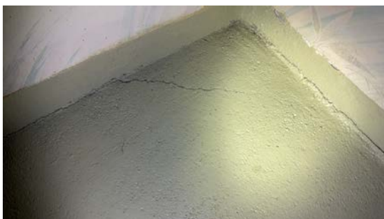
Sprekk i gulv
