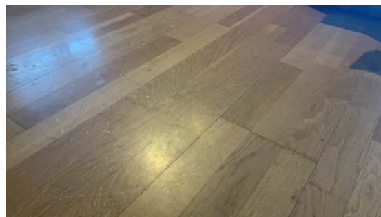
Slitasje på gulvoverflate
