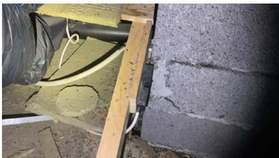
Det er foretatt avskaling av hjørne på pipe fra kryploft grunnet koblingsboks for avtrekk, sprekkdannelse på pipe i dette området
