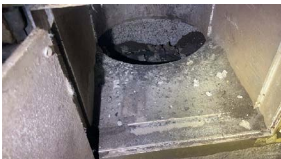
Manglende støpt bunn i sotluke i pipebunn
