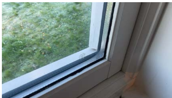
Kondensering er registrert på glass ubder befarng på flere vinduer
