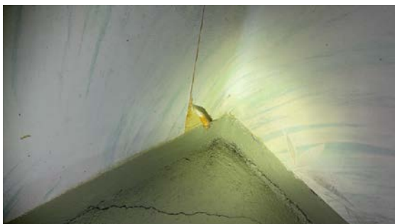
Slitasje på tapet
