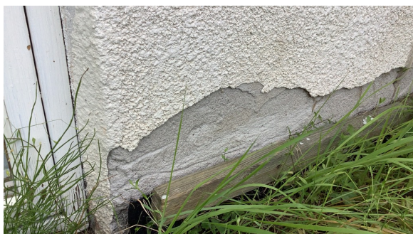
Område med manglende puss.
