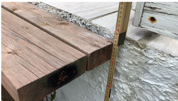
Tretrapp mangler rekkverk.
