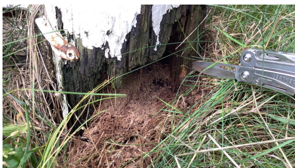
Råteskadet bærende trestolpe.
