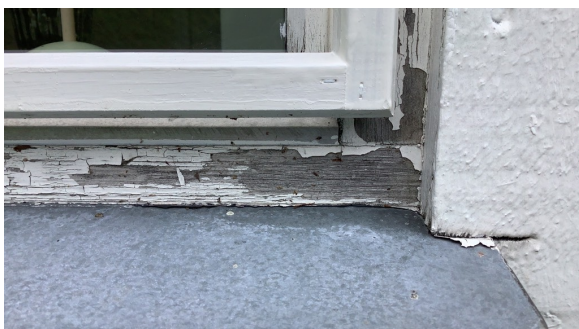
Eksempel på værslitt vindu.
