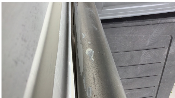
Eksempel på frostsprengt nedløpsrør.
