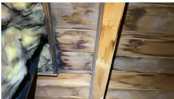
Fuktskjolder inntil luftehatt.
