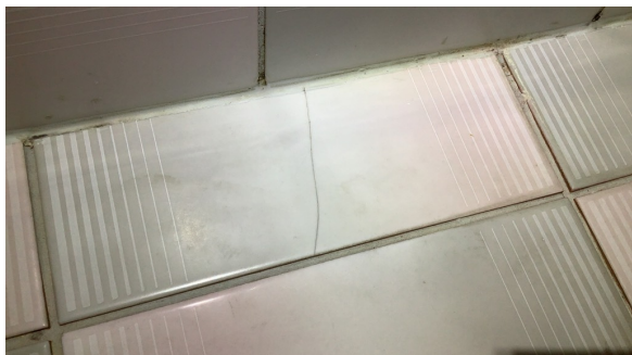
Sprukket gulvflis i dusjhjørnet.
