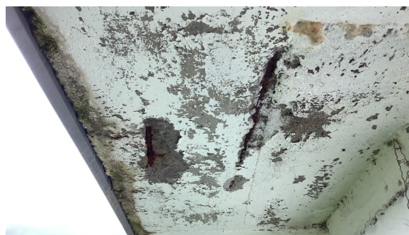
Eksponert armering under støpt dekke.
