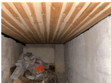
Det kan se ut til å være soppdannelse innerst i krypkjelleren.
