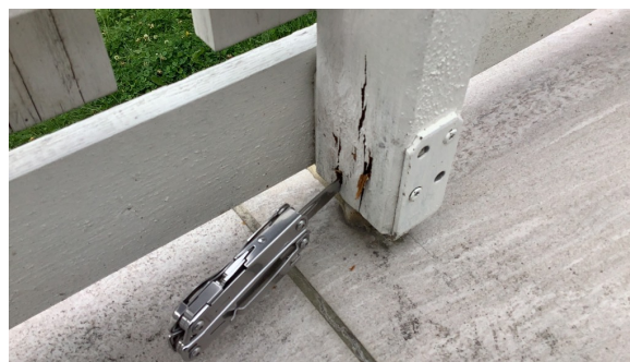
Eksempel på råteskadet rekkverksstolpe.
