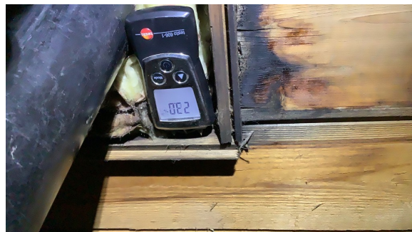
Fuktmåling i kasse rundt luftehatt, og det måles skadelig fuktinnhold.
