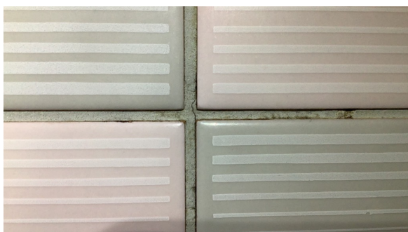
Riss i flisfuge i dusjhjørnet.
