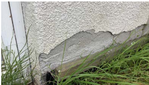
Område med manglende puss.
