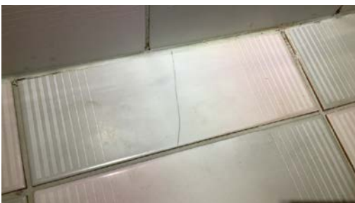
Sprukket gulvflis i dusjhjørnet.
