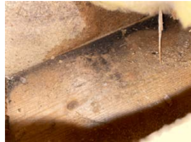
Hulltaking, og det er påvist sverting og fuktskjolder.
