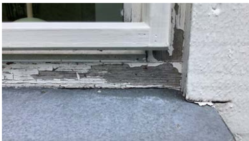
Eksempel på værslitt vindu.
