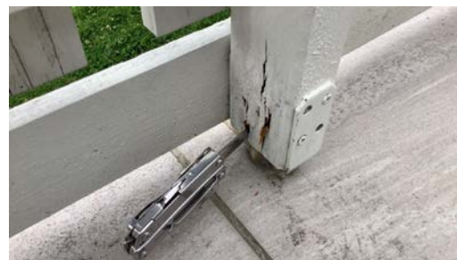
Eksempel på råteskadet rekkverksstolpe.
