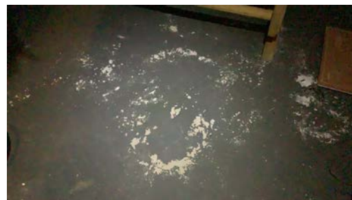
Saltutslag og løsnet maling i vaskekjeller.
