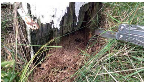
Råteskadet bærende trestolpe.
