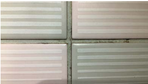
Riss i flisfuge i dusjhjørnet.
