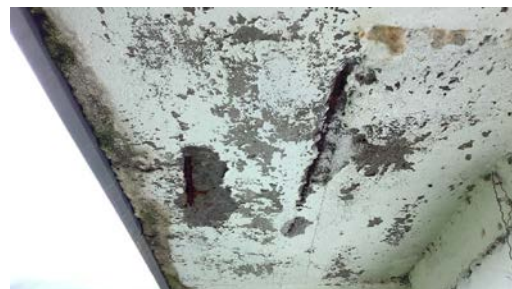
Eksponert armering under støpt dekke.
