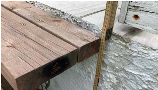
Tretrapp mangler rekkverk.
