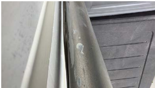
Eksempel på frostsprengt nedløpsrør.
