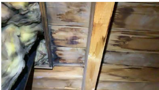
Fuktskjolder inntil luftehatt.
