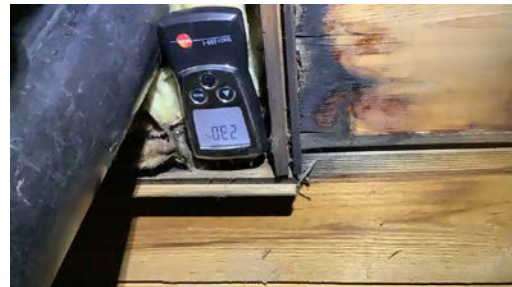
Fuktmåling i kasse rundt luftehatt, og det måles skadelig fuktinnhold.
