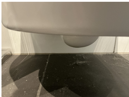
Det er ikke etablert drensspalte fra innebygget sistene.
