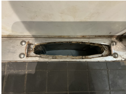
Slukrenne i dusjhjørne.
