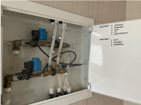
Foto av koblingskap for rør-i-rør-system
