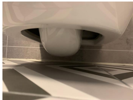
Mangler hull for å synliggjøre lekkasjevann fra sisternen.
