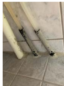
Ingen tegn til rørmansjetter eller at membran er ført opp over gulv
