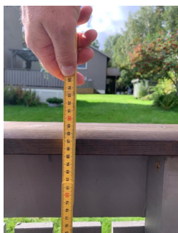
Noe lavt gelender i forhold til dagens krav.
