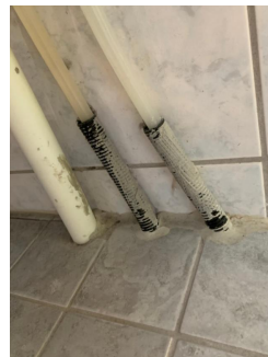
Ingen tegn til rørmansjetter eller at membran er ført opp over gulv
