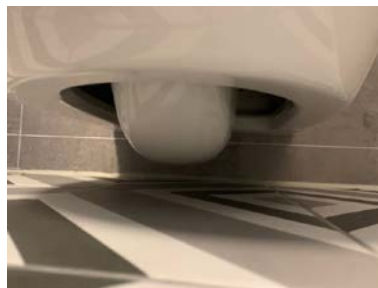
Mangler hull for å synliggjøre lekkasjevann fra sisternen.
