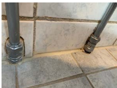
Ingen tegn til rørmansjetter eller at membran er ført opp over gulv
