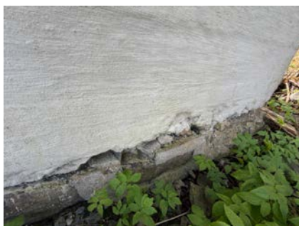
Flere området er med åpninger som bør tettes.
