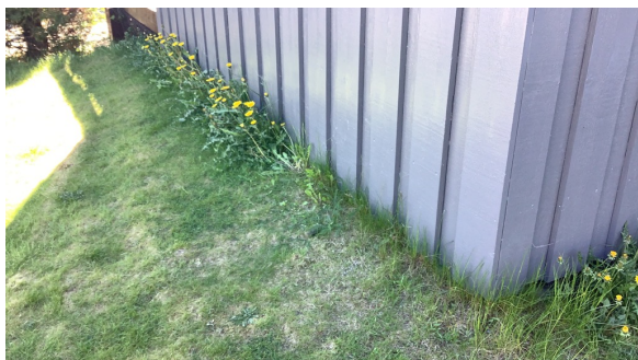
Bordkledning er ført nært terreng.
