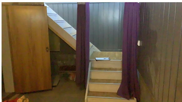
Trapp mangler rekkverk og håndløper
