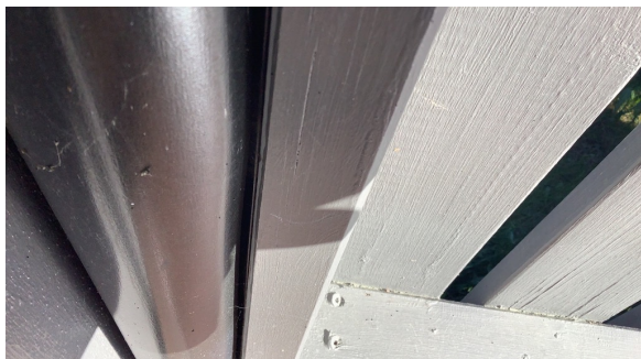
Eksempel på frostsprengt nedløpsrør.
