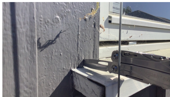
Omramming er stedvis ført helt ned til vannbrett, og dette har ført til spredte råteskader.
