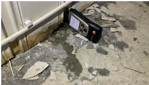
Panel er våt i området der vann kommer inn i kjeller.
