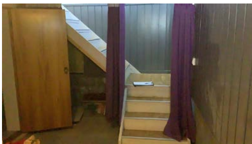
Trapp mangler rekkverk og håndløper
