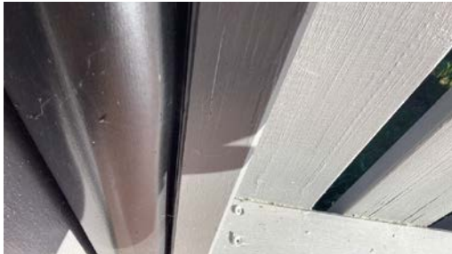
Eksempel på frostsprengt nedløpsrør.
