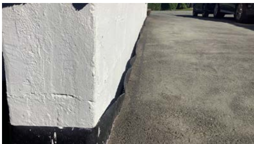
Det mangler tettelist i toppen av fuktsperre.
