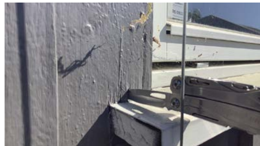
Omramming er stedvis ført helt ned til vannbrett, og dette har ført til spredte råteskader.
